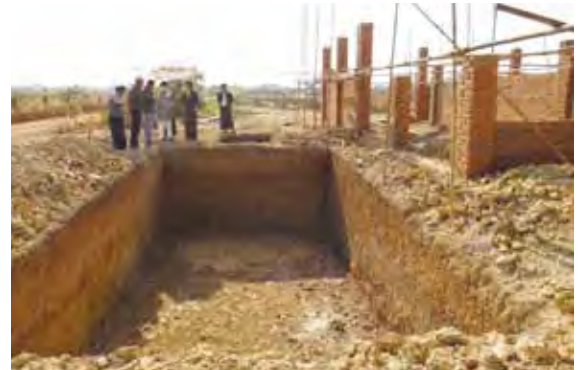
校舎の建設現場では、研修生が指導を受けながら進めています
